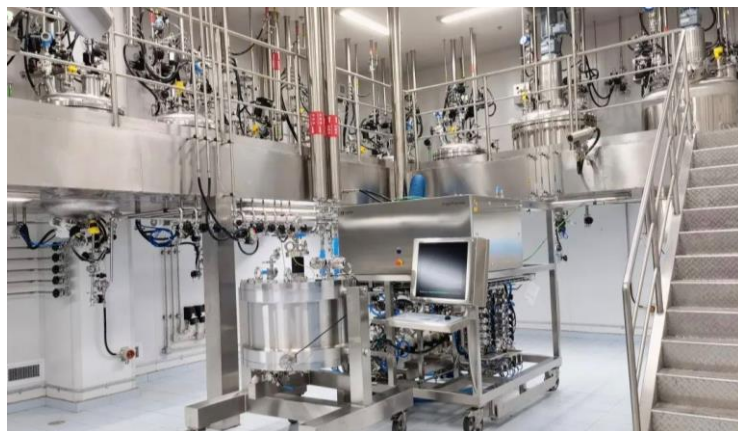
常州基地新的多肽与寡核苷酸生产车间
