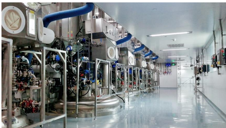
常州基地第二个高活原料药生产车间
